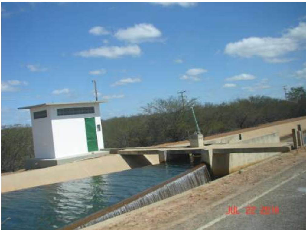
Sistema de controle de nível do canal Tipo “bico de pato” (mesmo sistema proposto pelas Consultorias para os canais do Sistema Taquarembó/Jaguari)
