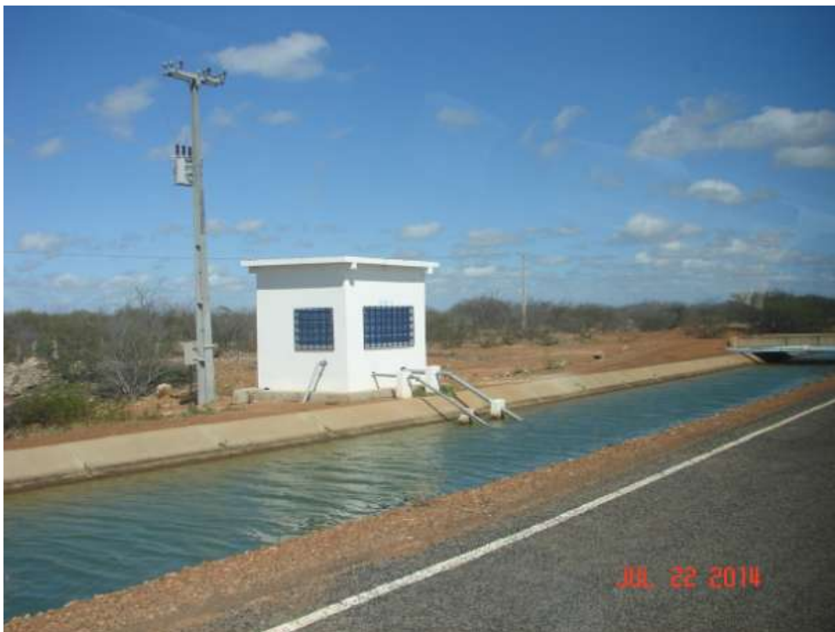
Estação de bombeamento/pressurização para fornecimento da água aos produtores
