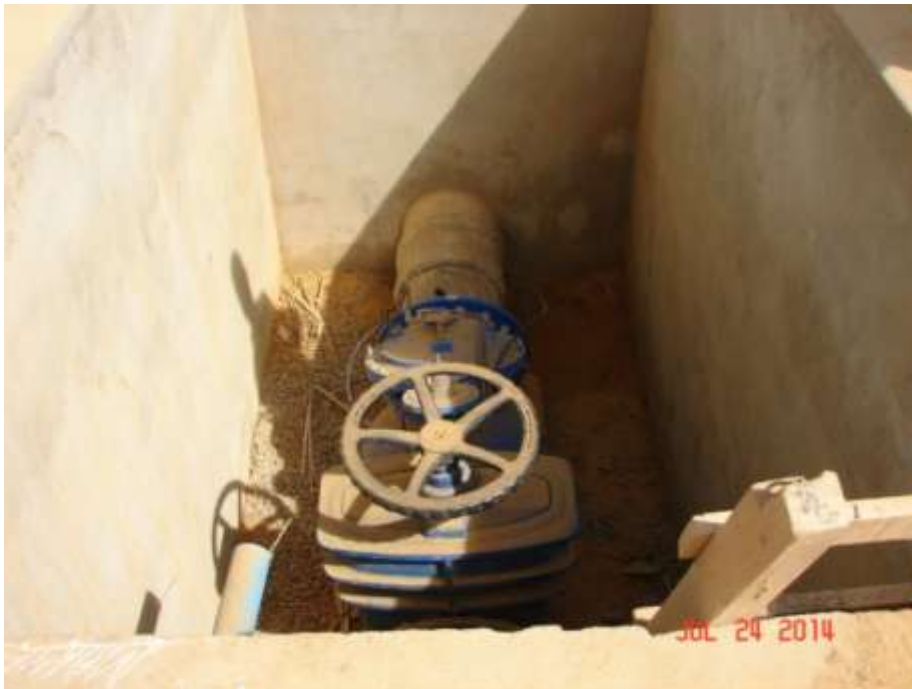
Sistema de controle/medição de fornecimento de água (fertilização) à Empresa Agrovale
