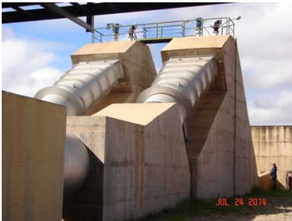
Projeto Salitre – Estação de Bombeamento Principal: capacidade instalada 2 conjuntos de 1.500 CV (7 m 3 /seg). Capacidade Final: 42 m 3 /seg
