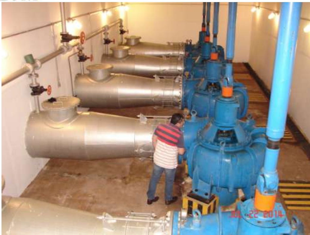
Projeto Pontal: Sistema de bombas – captação do rio São Francisco
