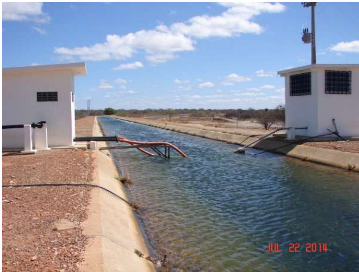
Captações no Canal Principal do Projeto Pontal
