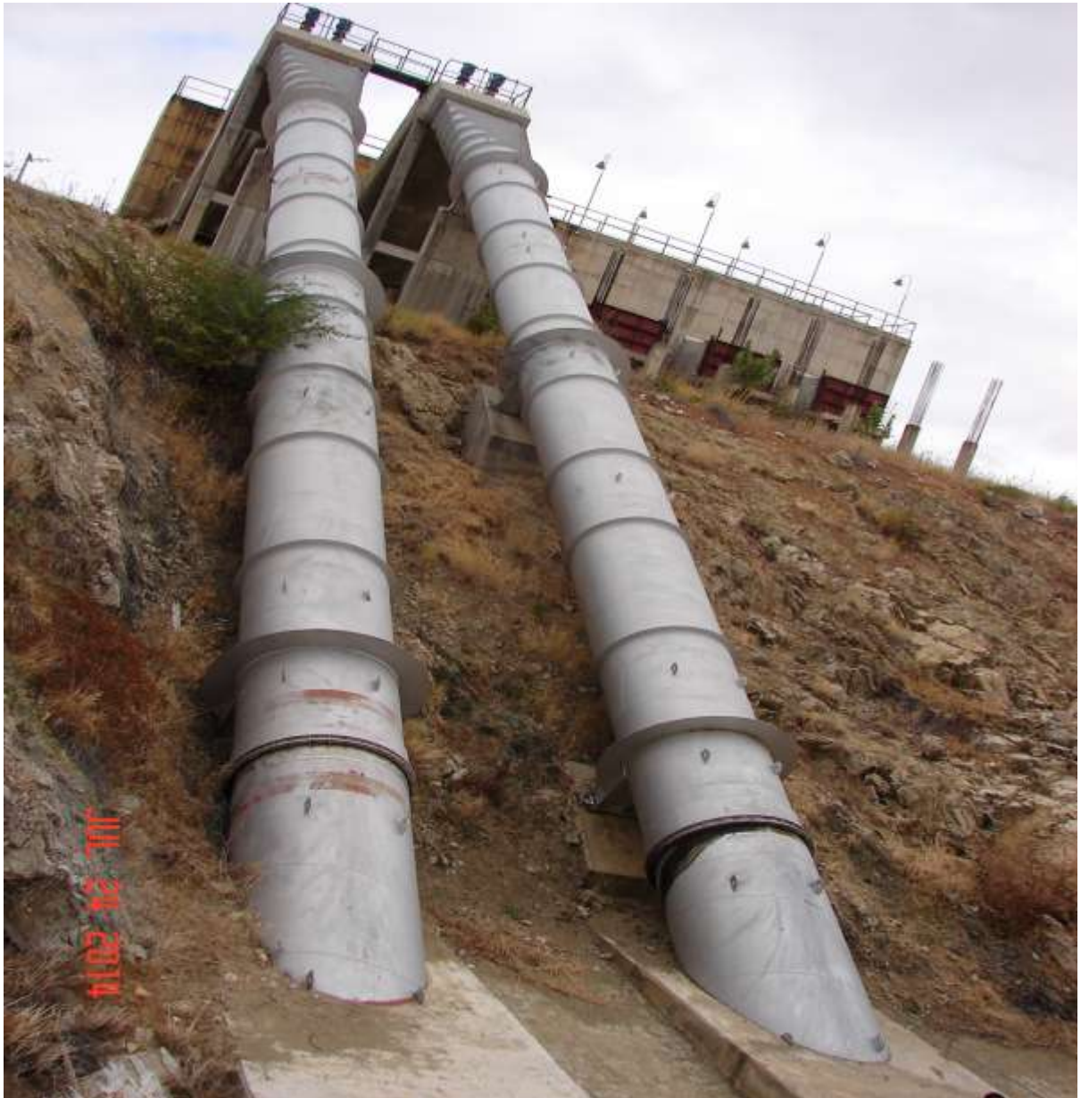
Projeto Salitre – 2ª Estação Elevatória: Adução
