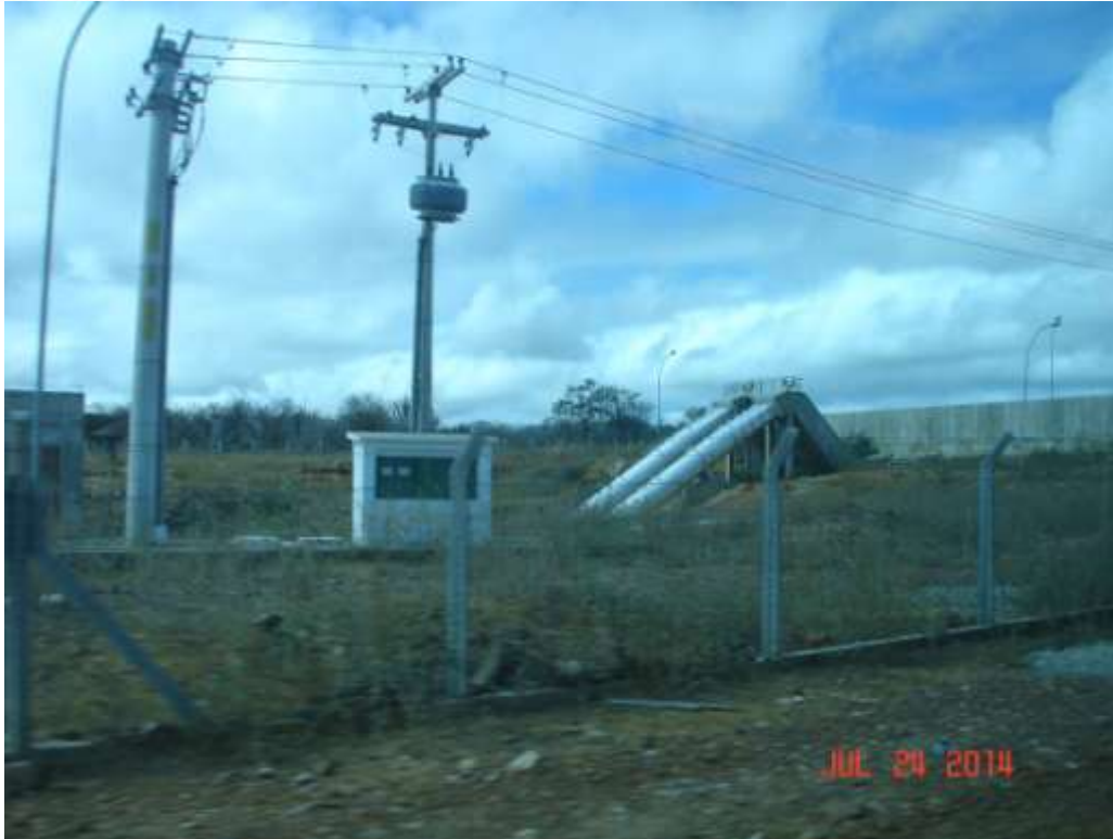
Projeto Salitre – 4ª Estação Elevatória
