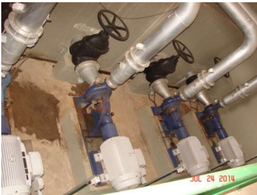
Sistema de Bombas – Estação Pressurizadora Projeto Salitre
