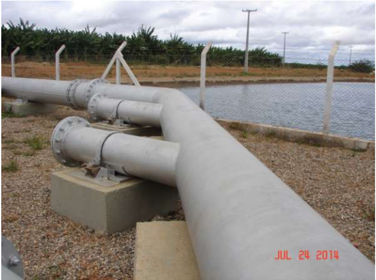
Saída da Estação de Pressurização com esperas para ampliação de atendimento
