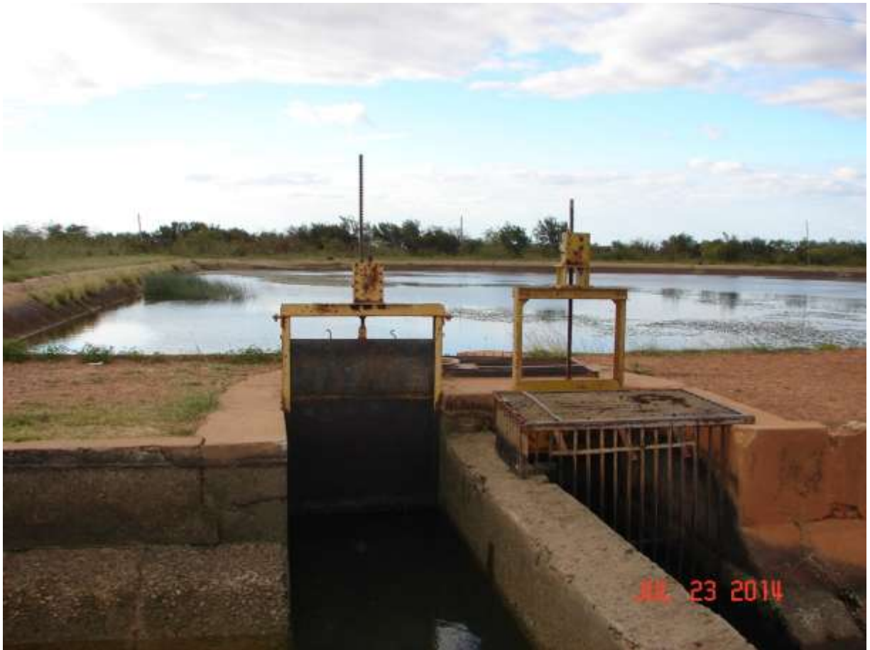
Distrito Mandacarú – Reservatório Pulmão – revestido – adução e distribuição
