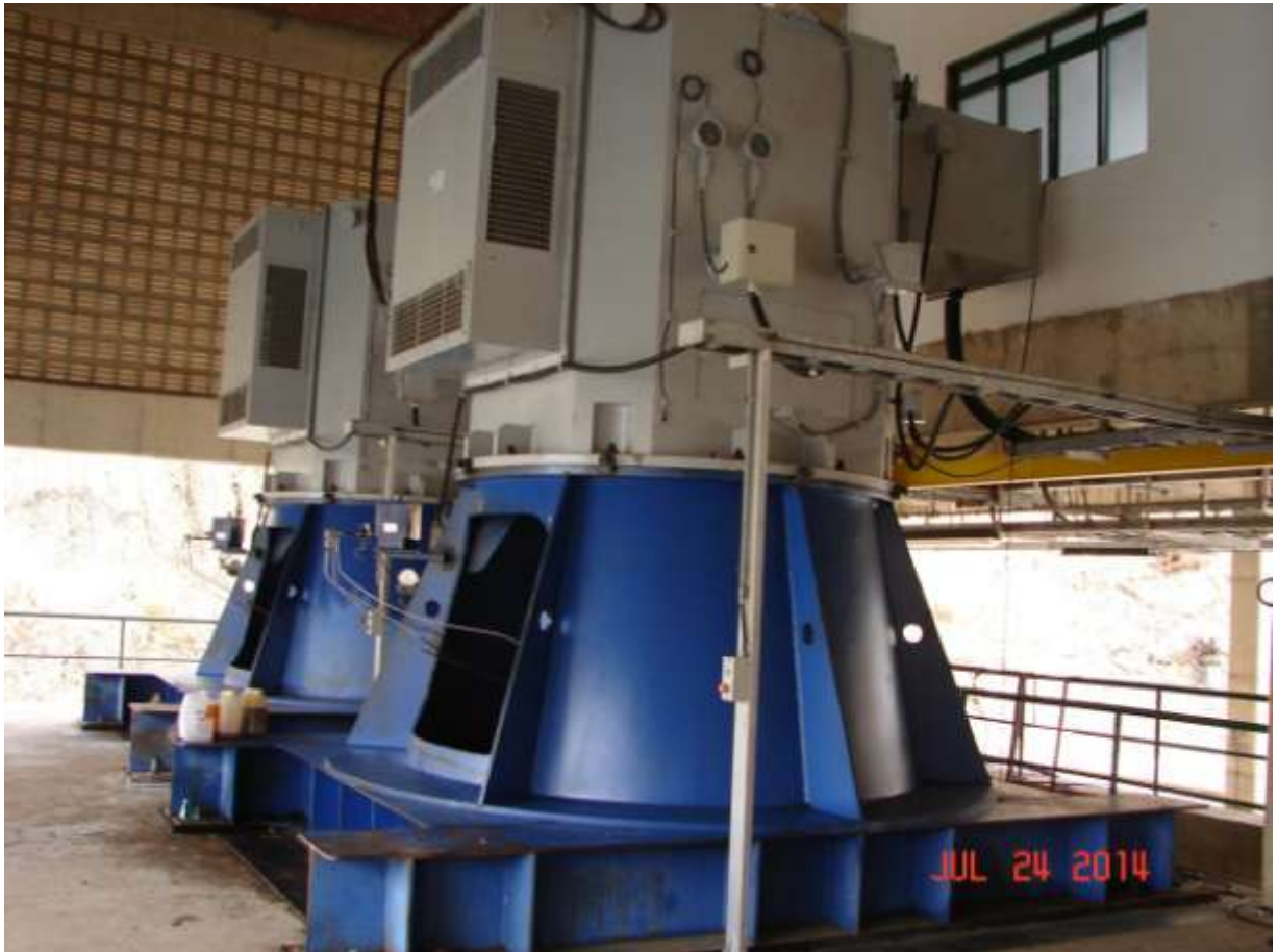
Projeto Salitre – 2ª Estação Elevatória: capacidade 14 m 3 /seg – 2 unidades de 2.000 CV
